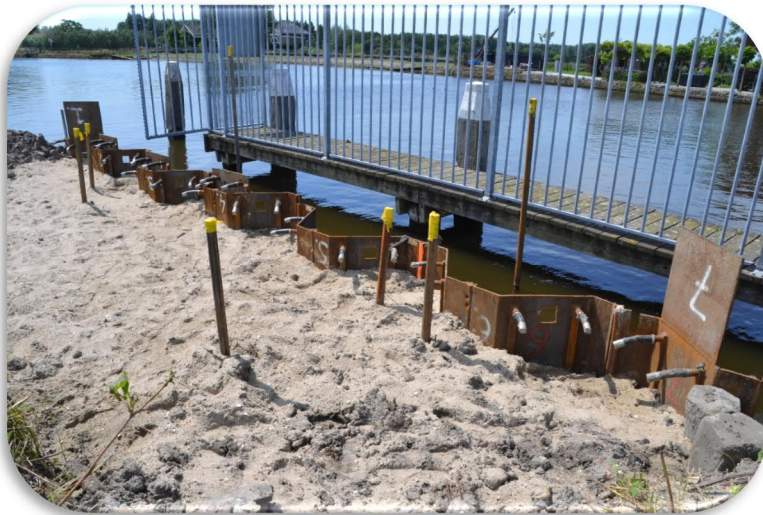
De energie damwand op de proeflocatie nabij Delft.
